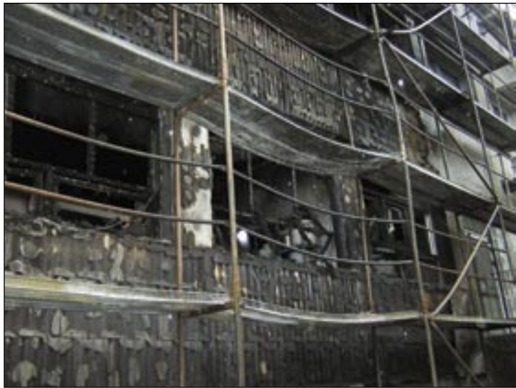
Ogień zniszczył świeżo ocieploną ścianę szkoły
